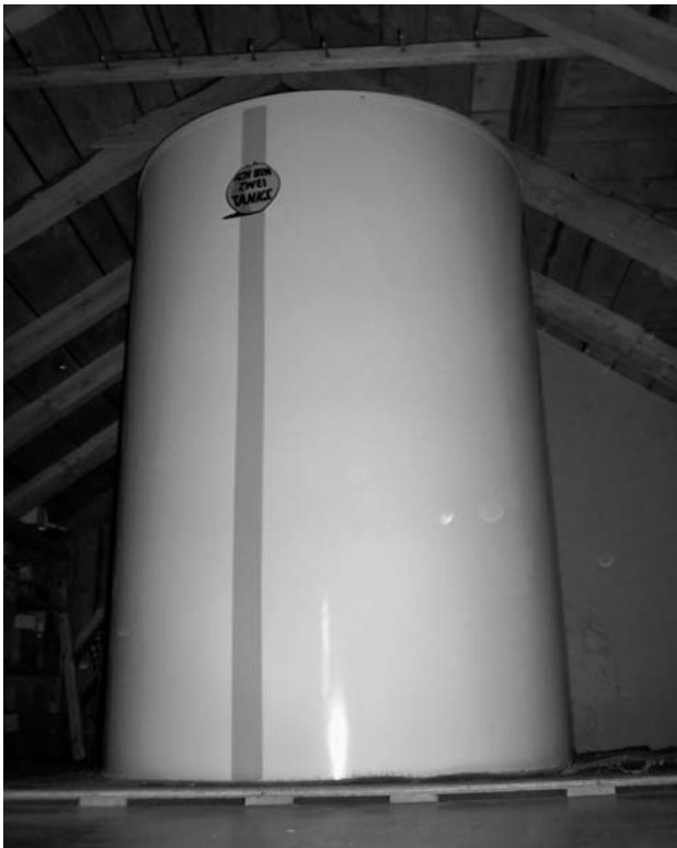
Abbildung 6: Speicher aus glasfaserverstärktem Kunststoff
