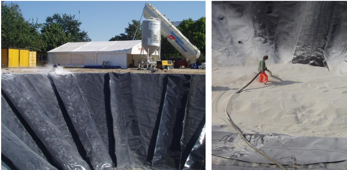
Bild 7: Einbringen der Wärmedämmung in HDPE-Sperrschichtbahn-Kammern sowie der Bodendämmung durch Einblasen aus dem Silo-LKW (Kies-Wasser-Wärmespeicher in Eggenstein, Quelle: ITW)
