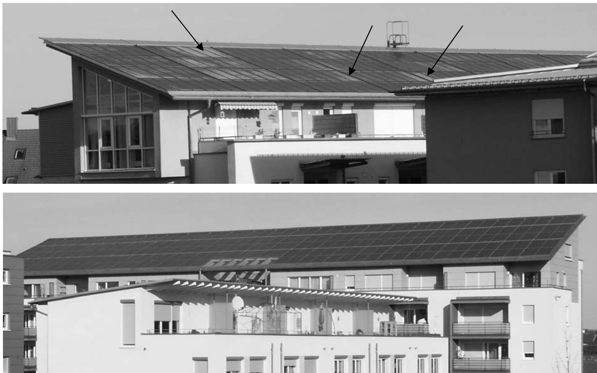
Abbildung 2: Beschlagene Kollektorfelder im 1. BA (oben) und freie Kollektorfelder im 2. BA (unten); 8. Januar 2008, 12:00 Uhr
