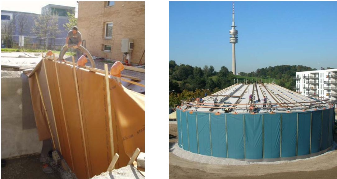
Bild 6: Blähglasgranulat in Membran-Schalung, Außenlaborversuche am ITW (Quelle ITW) und Projekt SNAB, München-Ackermannbogen (Quelle Solites)
