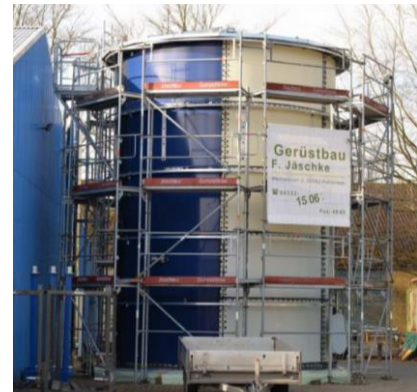
Abb. Außenaufgestellter Warmwasserspeicher in Segmentbauweise
